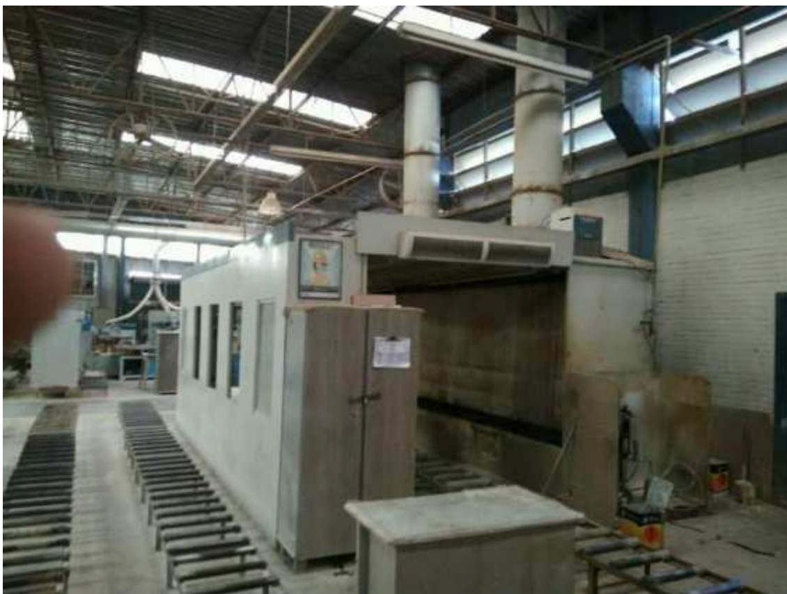
Fig. 118: Cabine de pintura
