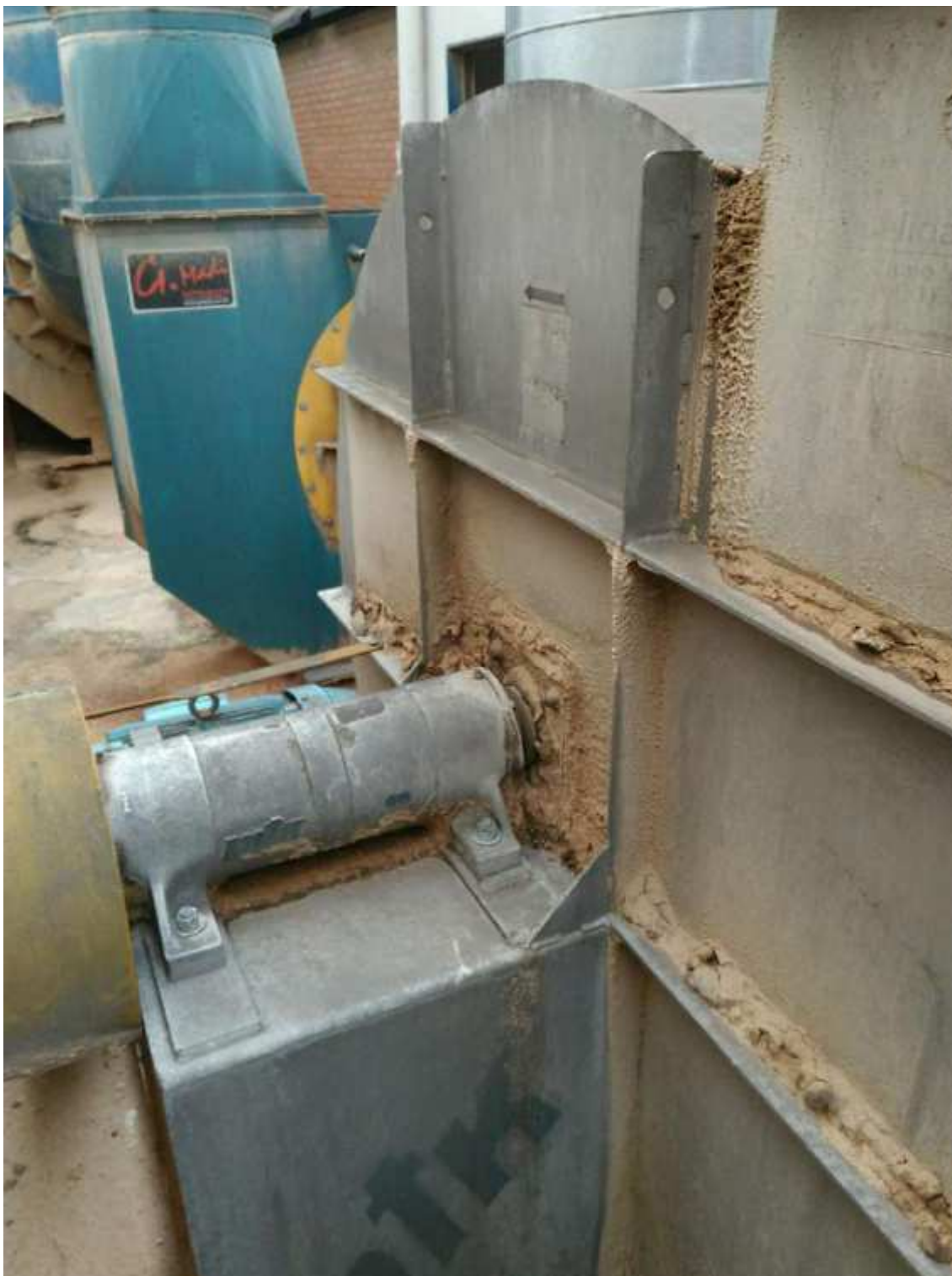
Fig. 34: Sistema de exaustão
