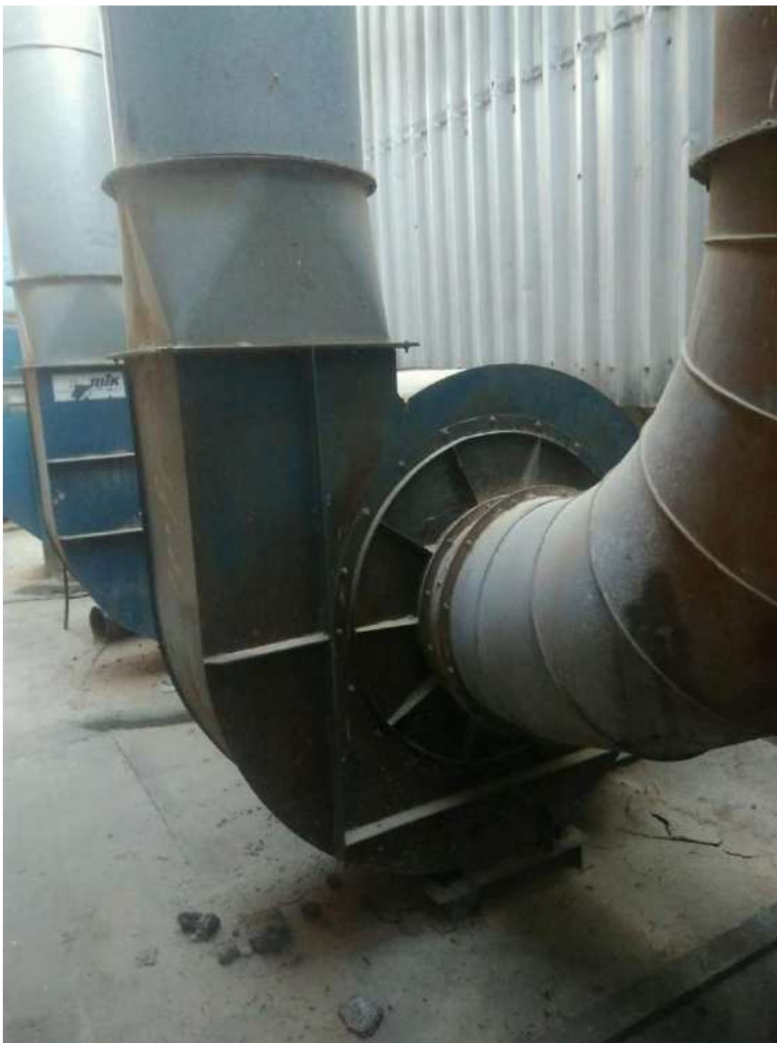
Fig. 37: Sistema de exaustão
