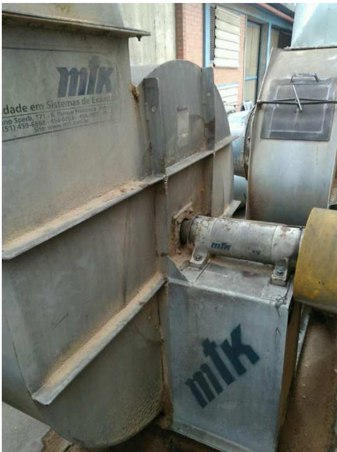
Fig.35; Sistema de exaustão
