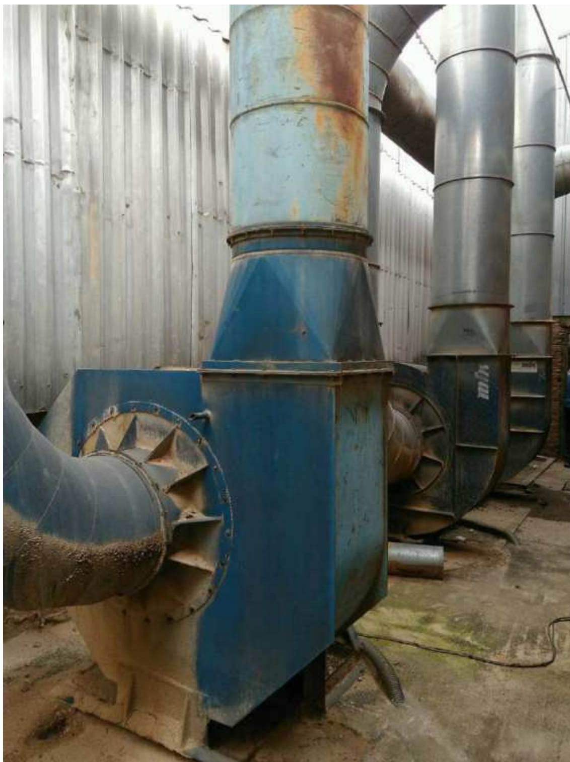
Fig. 26: Sistema de exaustão
