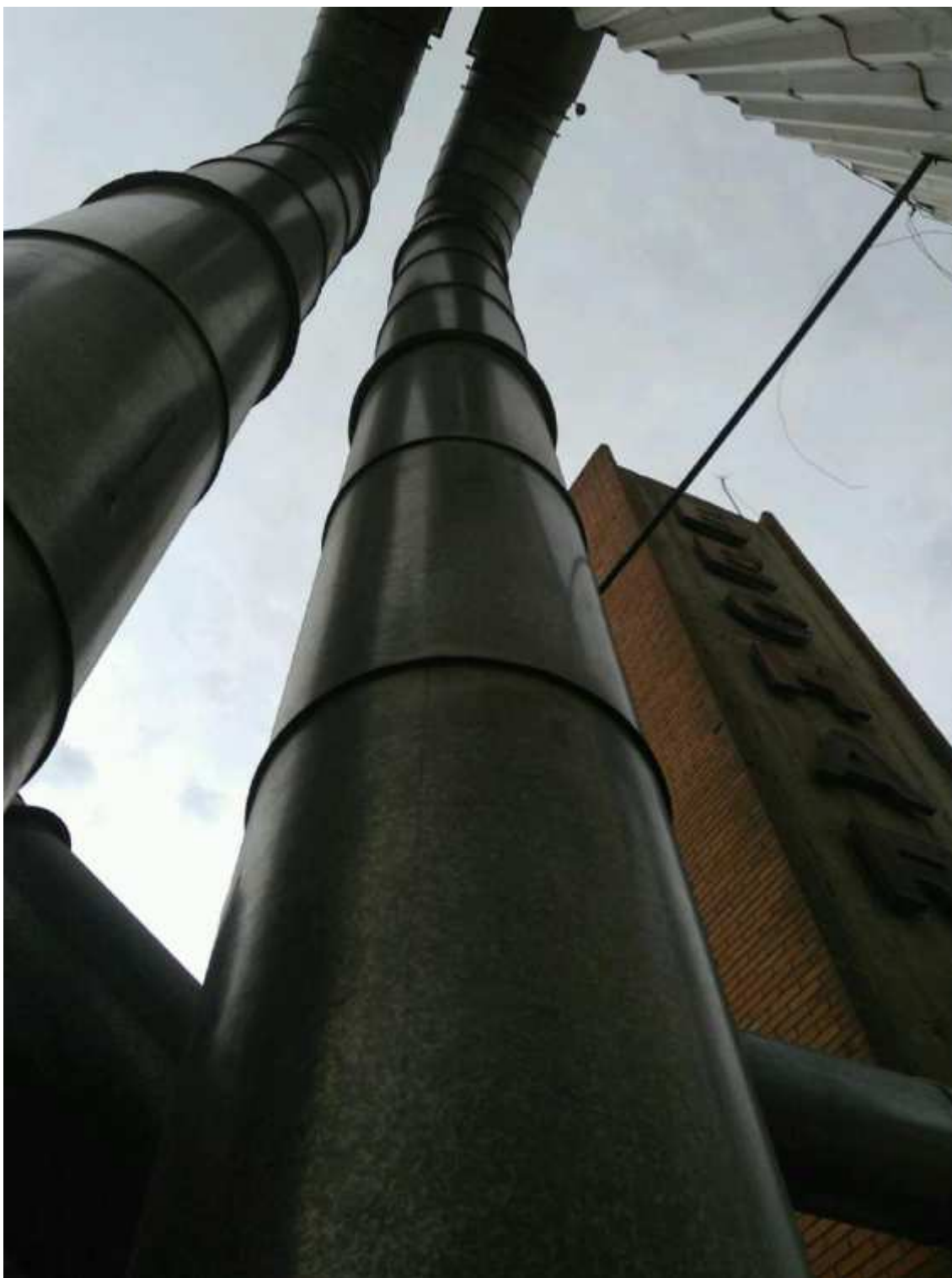
Fig. 33: Sistema de exaustão (tubulação)
