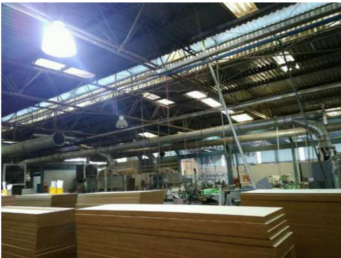
Fig. 27: Sistema de exaustão
