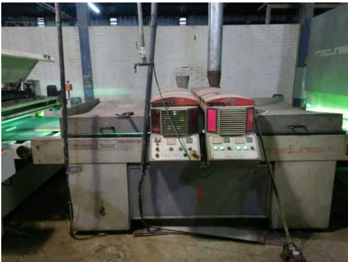
Fig. 245: Túnel UV 3 Lâmpadas
