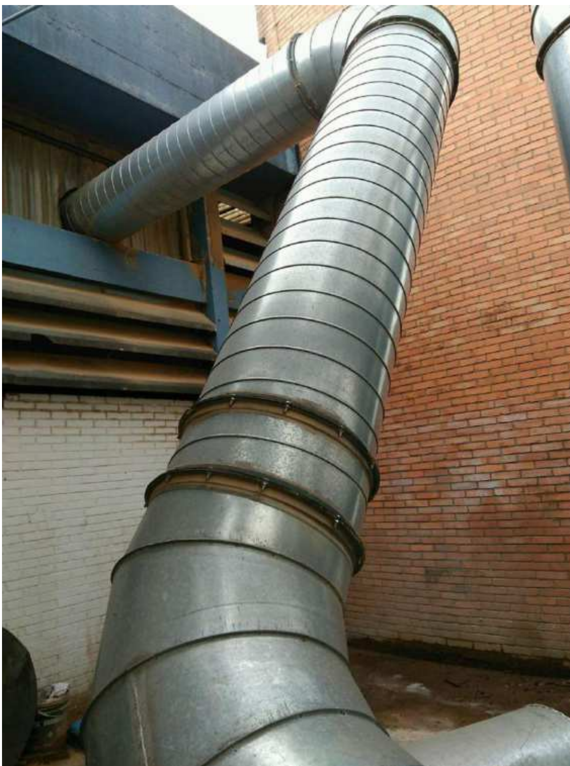
Fig. 31: Sistema de exaustão
