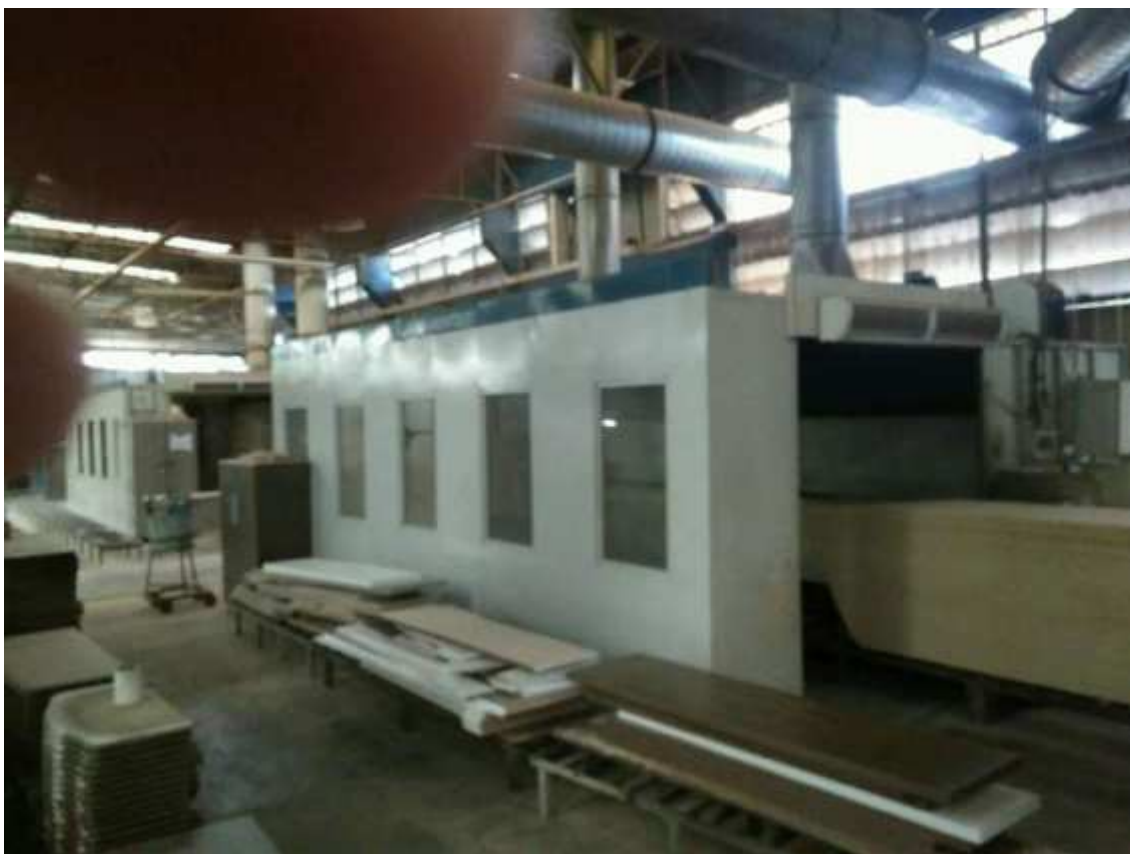
Fig. 119: Cabine de pintura
