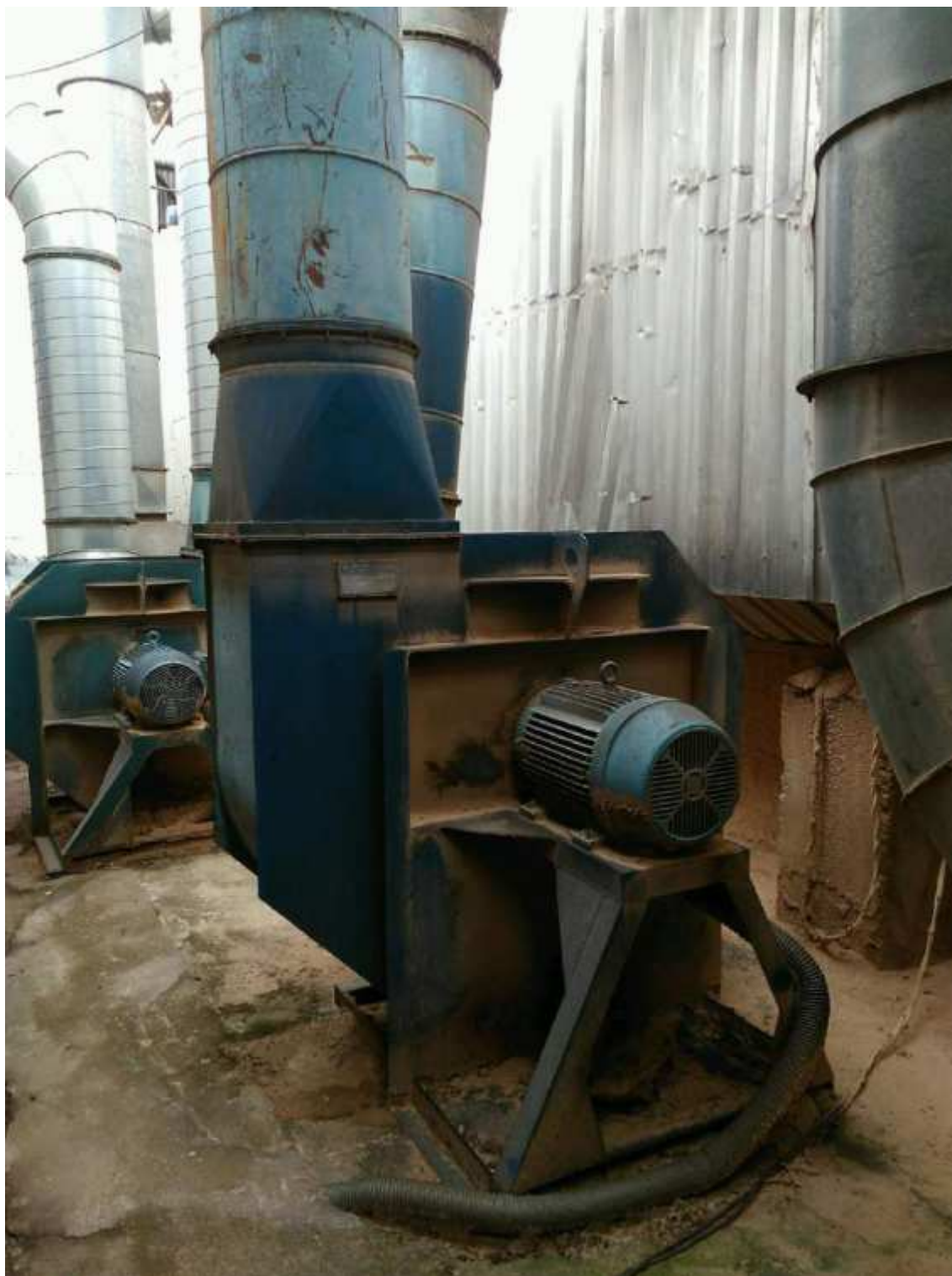
Fig. 28: Sistema de exaustão
